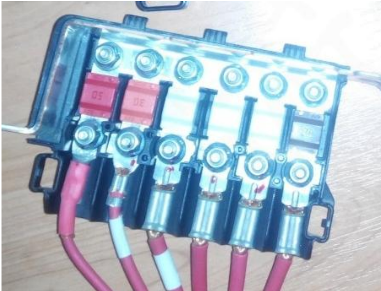
Bloc de fusibles haute puissance (2)
